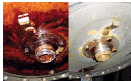
Крышка баллона загрязненный
